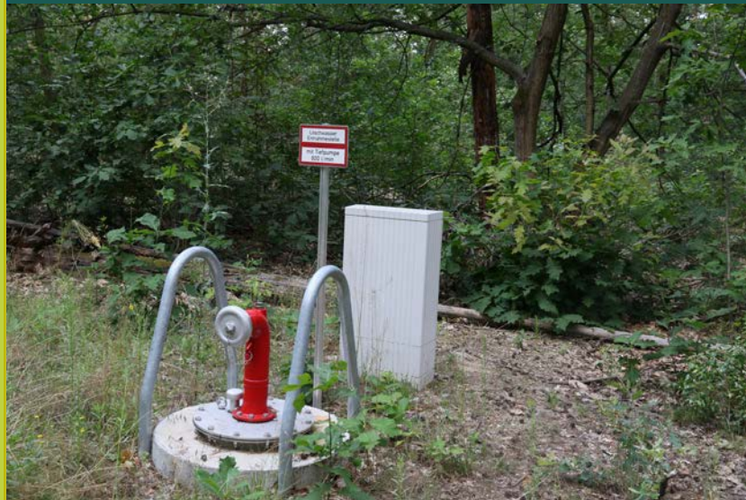
Löschwasserbrunnen in der Finsterwalder Bürgerheide, maximale Förderleistung 800 l/min; Foto: Dirk Knoche
